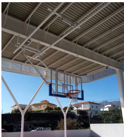
CANASTAS BALONCESTO: al techo multitubo y elevación mediante motor.
